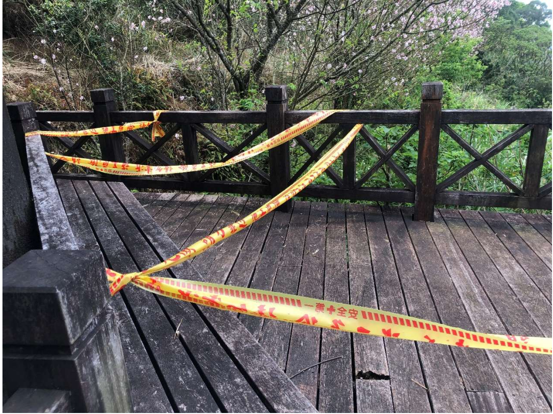
圖十一 損壞的觀景平台
