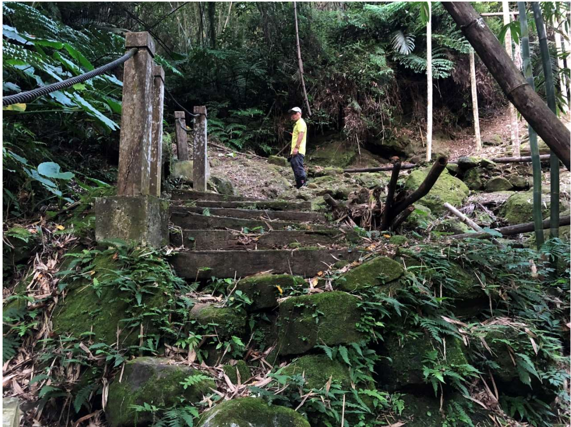
圖十 損壞的階梯設施
