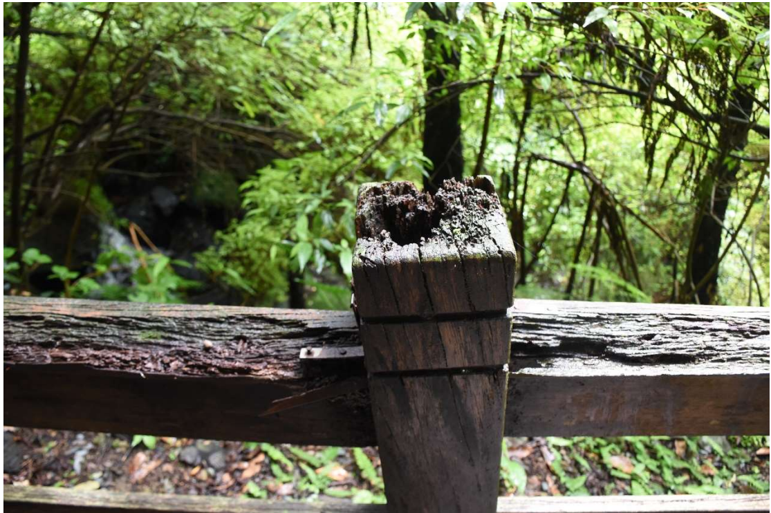
圖十二 損壞的欄杆設施
