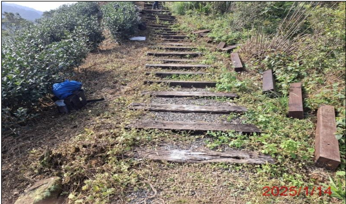
圖八 損壞的階梯設施
