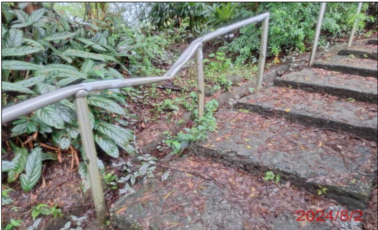
圖九 損壞的欄杆設施
